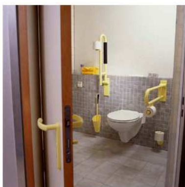
Casa de banho acessível a pessoas com deficiência motora
