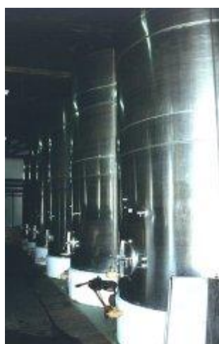
Tanques de aço inox
